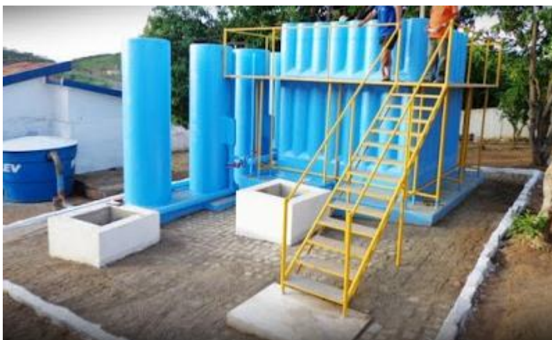
Figura11: Estação de tratamento d'água na CAGEPA de Santana de Manguiera. (Fonte: Jackeline Ferreira Simões Manguiera 2015)
